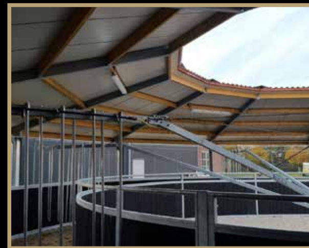
Izolované střešní desky a LED osvětlení
