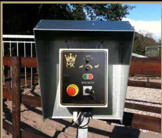
Ochranný kryt s pozinkovaným stojanem na betonovém základu
